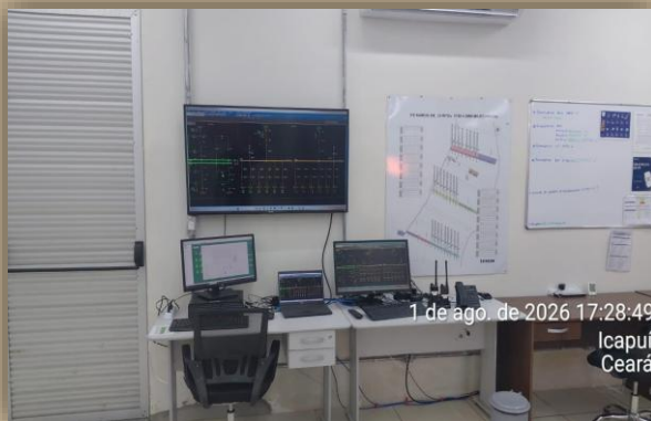
Sala de comando
