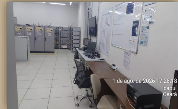
Sala de comando
