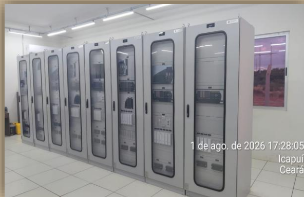
Sala de comando
