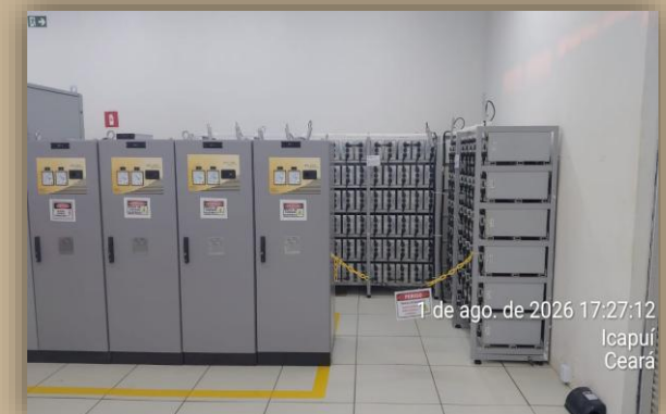
Sala de comando
