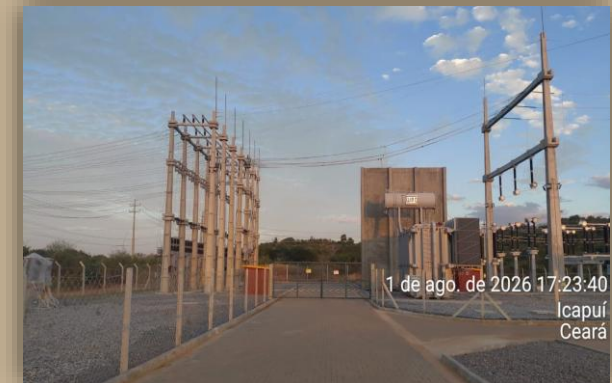
Pátio de alta tensão
