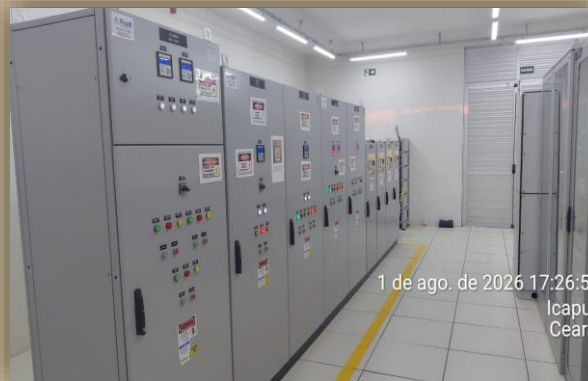
Sala de comando
