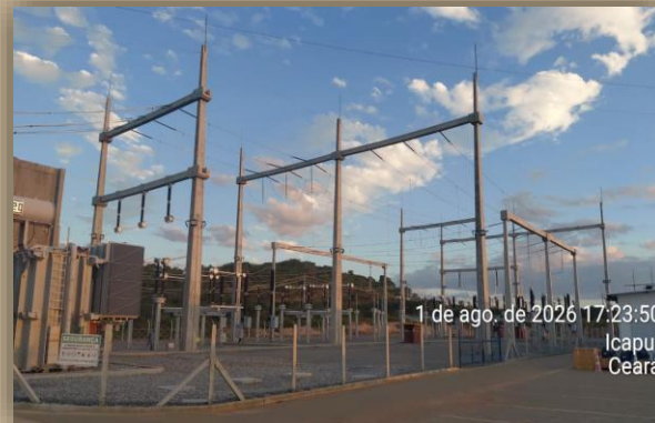
Pátio de alta tensão
