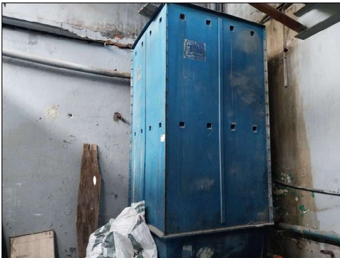
ITEM 072 - TORRE DE RESFRIAMENTO TR COM MOTORES
