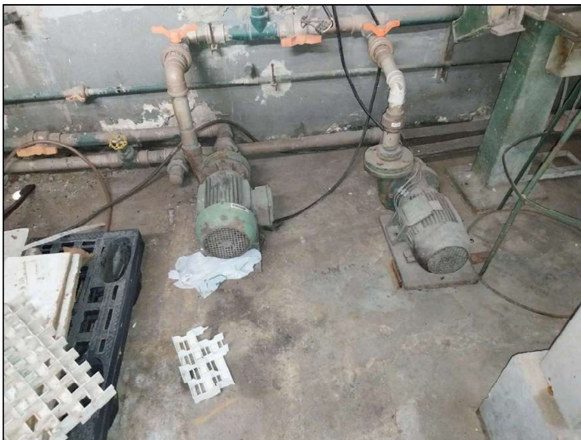
ITEM 072 - TORRE DE RESFRIAMENTO TR COM MOTORES
