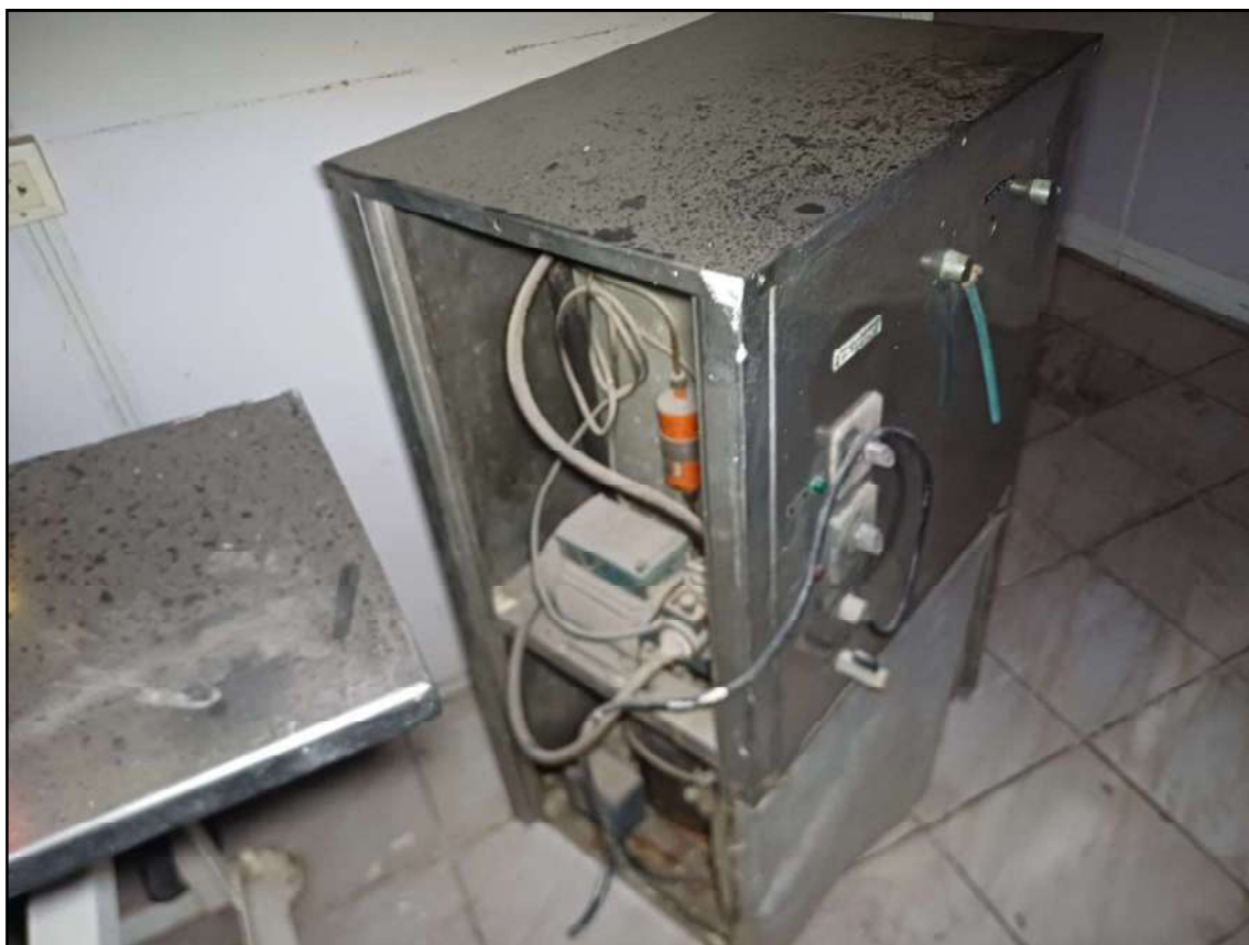
ITEM 100 - UNIDADE DE REFRIGERAÇÃO
