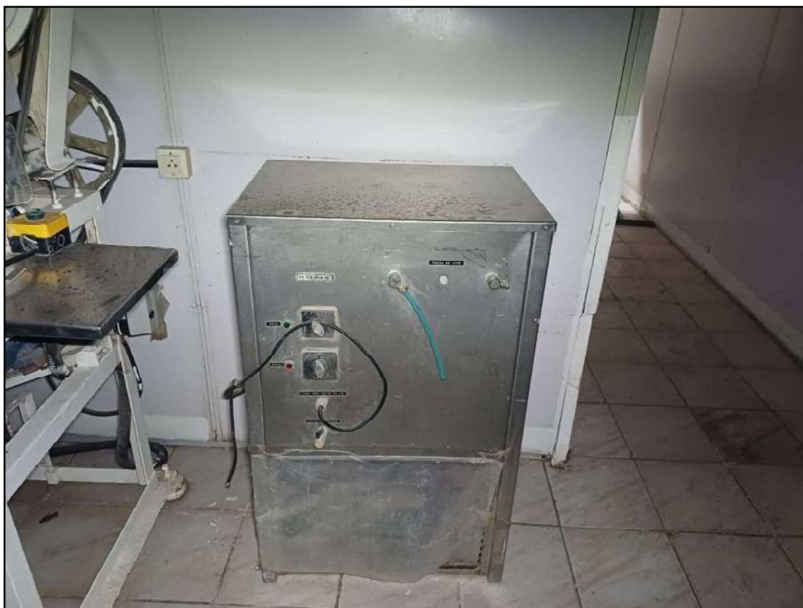
ITEM 100 - UNIDADE DE REFRIGERAÇÃO
