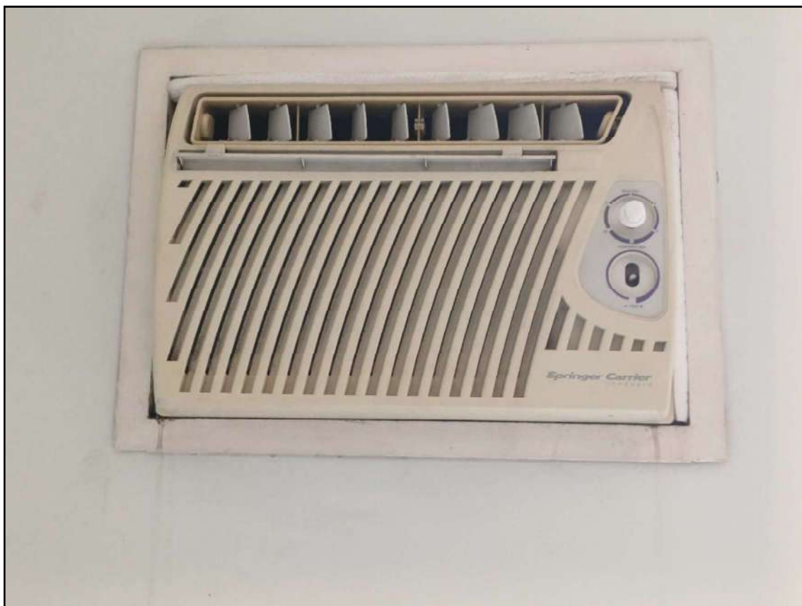
ITEM 093 - AR CONDICIONADO DE JANELA SPRINGER CARRIER
